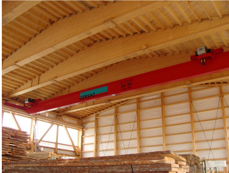
Brückenkran mit Winkelkatze
