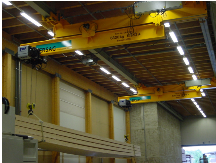
Deckenlaufkran mit Ausschieber
